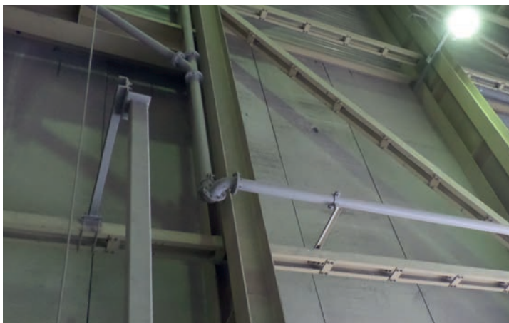
Afb. 5 Voorbeeld van een stofzuigleidingwerk met te korte bochten
