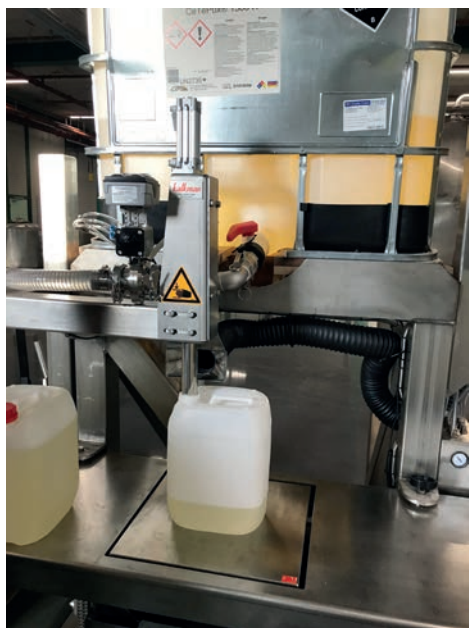
Afb. 9 Detail van de afvulininstallatie met een dampafzuiging direct achter de vullans
