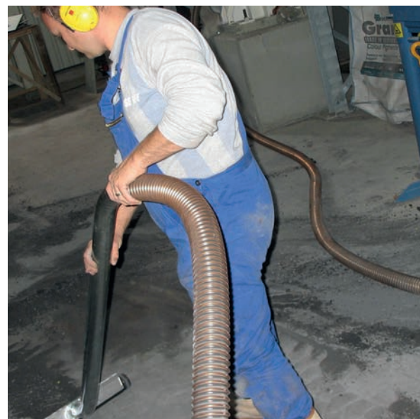
Afb. 7 Mobile stofzuiginstallatie met een 60 mm zuigslang
